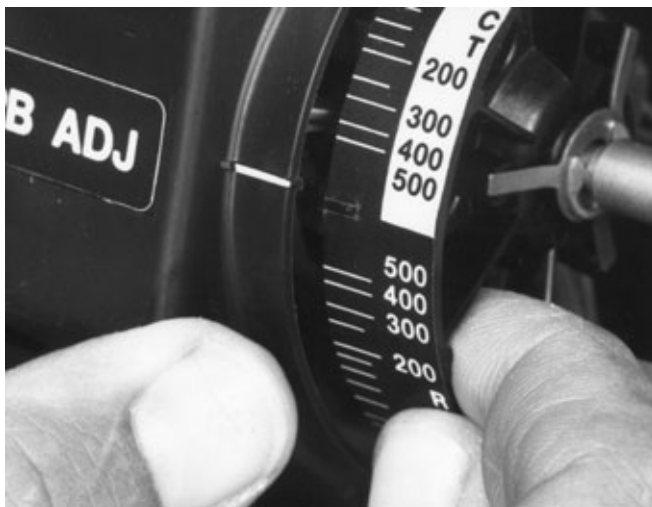
Рис. 15. Действие контроллера Fisher 4196В, смена контроллера
